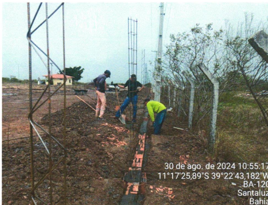
Foto 13 - (COMPOSIÇÃO REPRESENTATIVA) EXECUÇÃO DE ESTRUTURAS DE CONCRETO ARMADO, PARA EDIFICAÇÃO INSTITUCIONAL TÉRREA, FCK = 25 MPA. AF_01/2017
